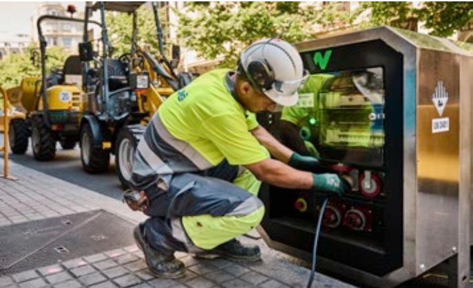
Voorzie de hele bouwplaats van stroom, autonoom of als netvoeding.
